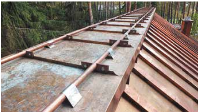
Общая длина двух коньковых пешеходных трапов (система безопасности) на разных уровнях размещения на кровле составила немногим более 13 пм, что в свою очередь позволяет производить безопасное обслуживание кровли (чистка кровли и желобов от еловых и сосновых иголок).
