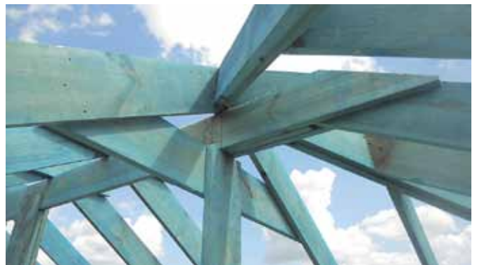
Рис. 3. Узел конькового прогона на вальме – одинарная стропильная нога с двумя накладными элементами (вид снизу)
