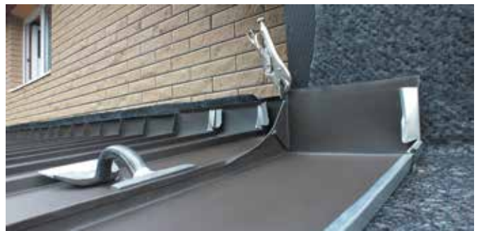
е) вид угловой картины со стороны внутреннего свернутого шва с переходом из двойного в одинарный фальц и применением ручной лопатки (шалайзен) имеющей специальную обрешиненную основу для работы с полимерными покрытиями металлов
