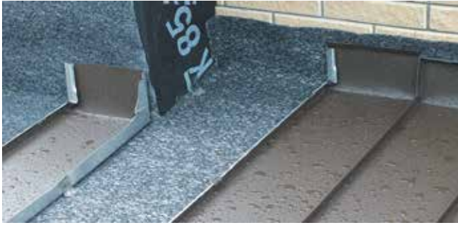
а) общий вид внутреннего и внешнего углов деревянного короба фронтона свеса кровли сопряженный с нижележащим навесом в процессе укладки фальцевых картин шириной 220 мм
