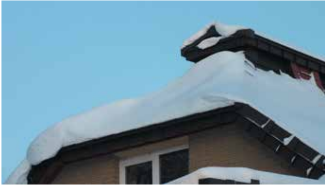
Большой объем снежной массы на карнизном свесе вальмы показал эффективность применения установки точечных снегопопоров ручной работы
