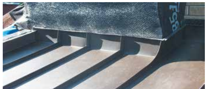
з) общий вид завершения работ по монтажу фальцевых картин имеющих прямой, лотковый и полукруглый конверты с примыканием к вертикальным частям здания и кровли в целом
