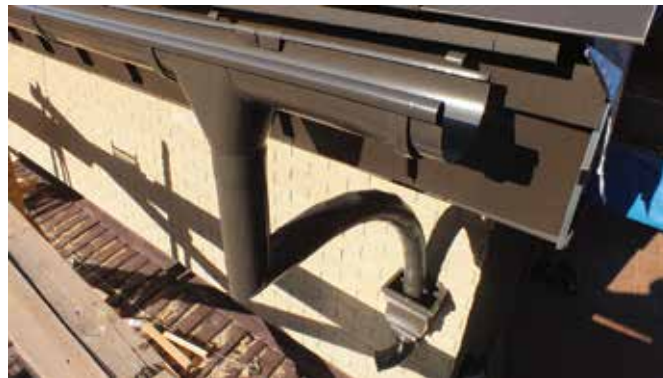
Общий вид швейцарского колена и водосборной пристенной декоративной воронки
