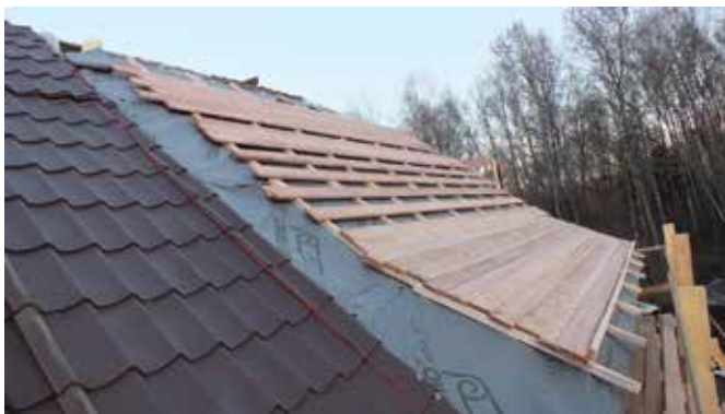
Перепад высоты между старым и новым кровельным покрытием
