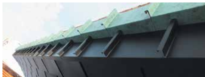
Обрамление двухуровневой лобовой доски выполнено в виде малых фальцевых картин закрепленных в шахматном порядке (техника декоративного Г-образного стоячего фальца)
