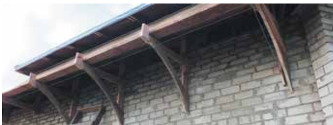
Этап работы по установке и монтажу вогнутой радиусной части карнизного свеса кровли с длиной дуги 900 мм
