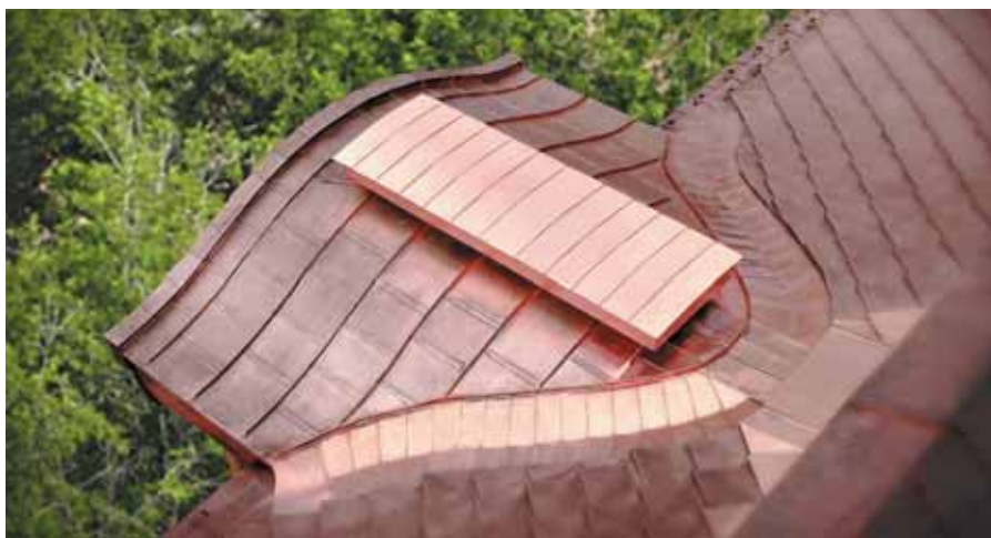
Участок Панцирь Королевской черепицы (окно #1) расположенный на задней части участка Корабль в сопряжении с штучной черепицей – объемный ромб с центральным переломом. Бантовая цельная складка. Техника двойного стоячего фальца. Полуокруглые конверты. Вентилируемый конек. Декоративная внутренняя рейка.
