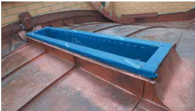
(а) Общий вид конькового аэратора установленного на арочной кровле
