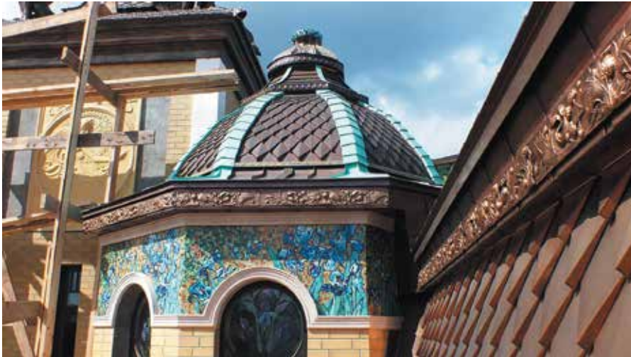
Вид с балкона на купол размещенный на многогранном эркере здания с установленной лапой Виверны и декоративным фонарем созданных по личным эскизам Заказчика
