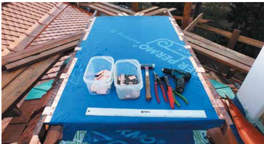
Укладка синтетической трехслойной мембраны Klover Extreme SK играет важную роль в качестве разделительного слоя между деревом и металлом – перед укладкой фальцевых картин на пологом навершии
