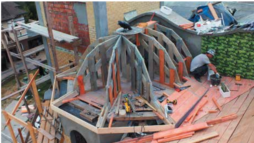
Возведение каркаса фермы велось строго по техническому заданию архитектора с соблюдением уклонов на всех гранях и установкой контрольных отметок высот
